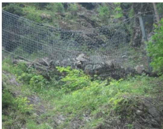
„randvolle Auffangnetze“ oberhalb der Straße nach Luitl (Foto: Gemeinde Tobadill).
